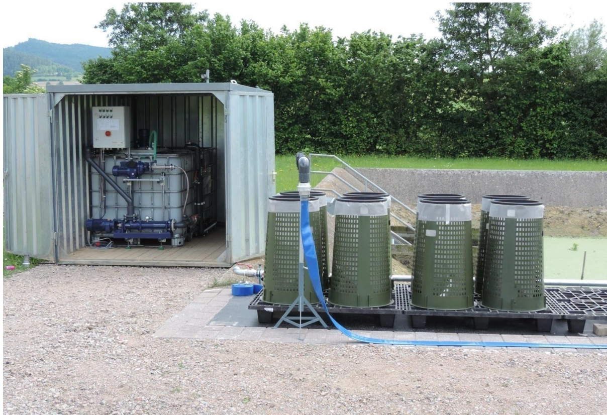
OBRÁZEK 9: UKÁZKA ODVODŇOVÁNÍ KALŮ NA MALÉ ČOV
